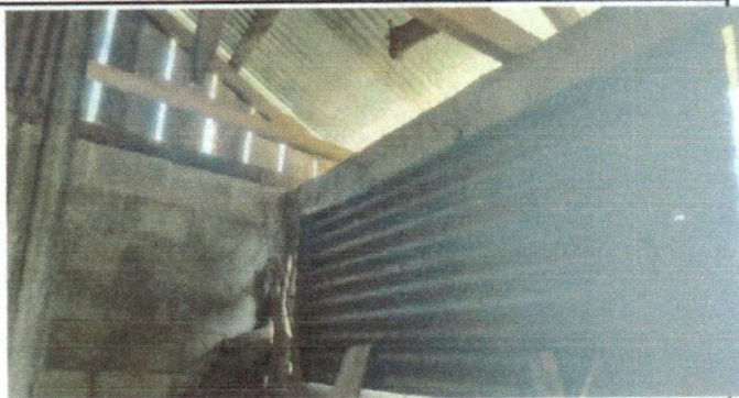
Foto 3: Se observa falta de pintura en la pared.
